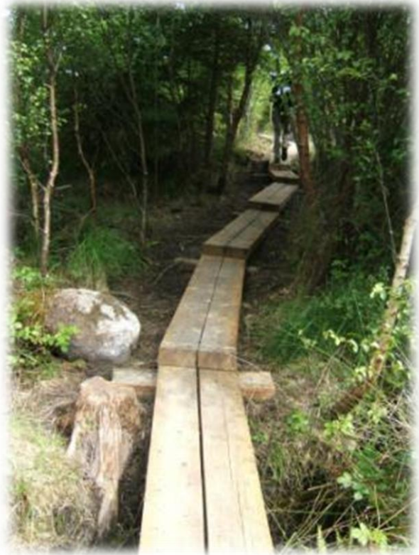
Gewone balken. De biels zijn op.
